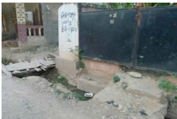
Images 35 et 36. Certaines rues du quartier montrent une partie d'un réseau d'égout en très mauvaises conditions. Photo: Teresa Tapada
